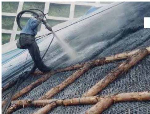
丸太植栽工又は丸太法枠工の斜面間に 植物の生育基盤を吹付(P M C 工法)
